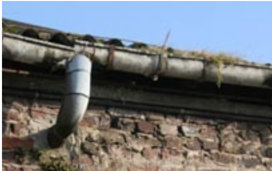
Fehlerhafte Einleitung des Fallrohres und Rinnenbeschädigung mit Bauschaden in der Fassade (Bemoosung)
