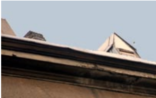
Rinnenschaden durch Überlauf und Rost, Bauschaden an der Fassade
