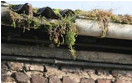
Verstopfte Dachrinne durch unsachgemäße Pflege und Pflanzbewuchs
