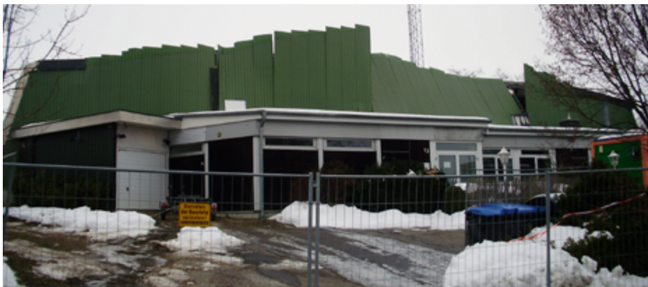
Einsturz Hallendach durch Hohe Schneelast; Foto Behrens
