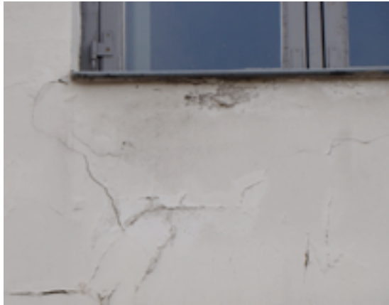
Denkmal Feuchteschaden Fassade
