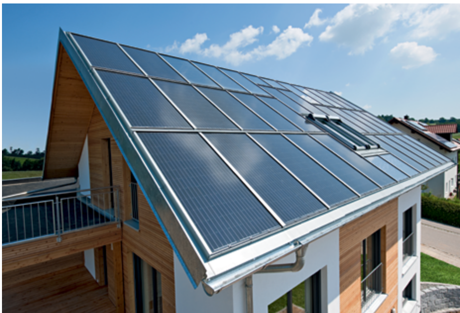
Dachintegriertes Solarsystem: alle Fotos Roto
