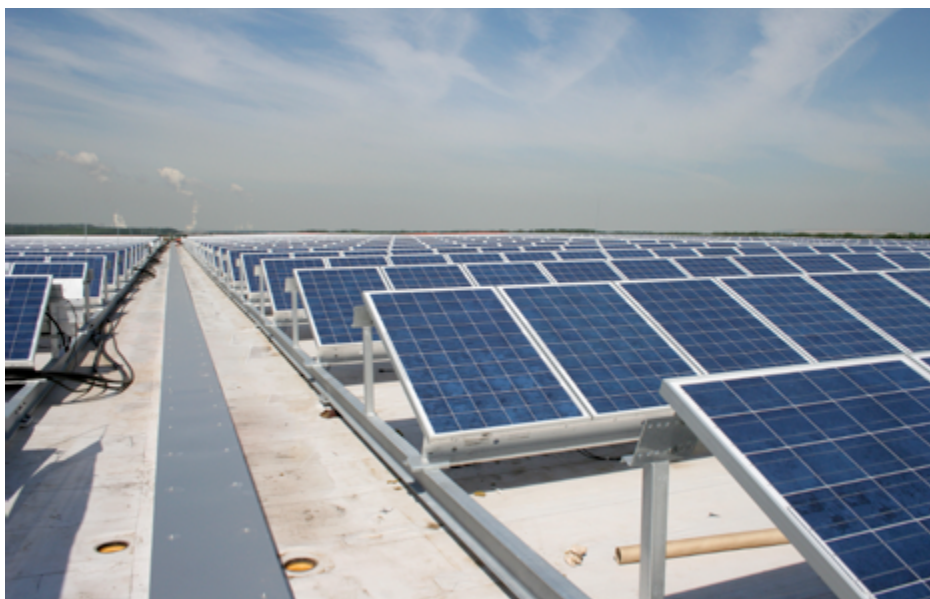
Hallendach PV-Anlage; Foto Krolkiewcz
