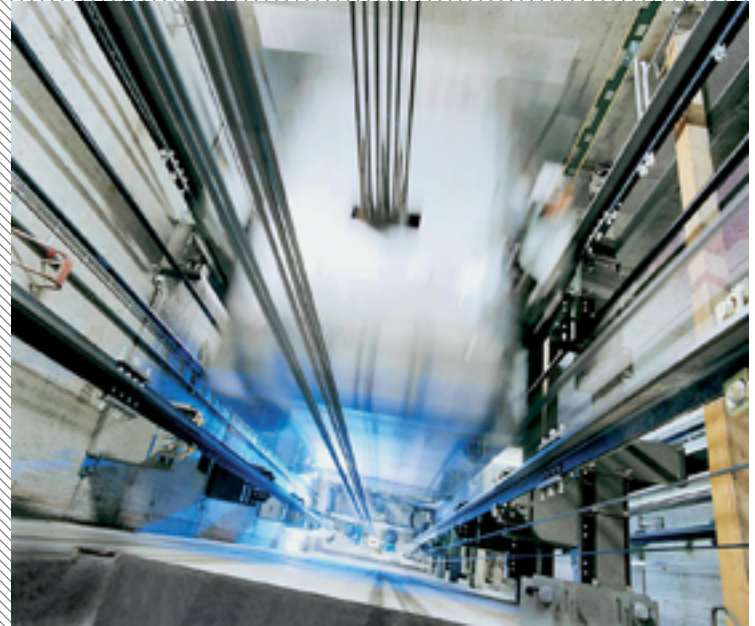
Rückspeisung, Foto Schindler Deutschland
