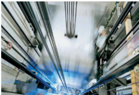
Rückspeisung; Foto Schindler
