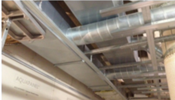
Klimakanäle in Decke Aqualon
