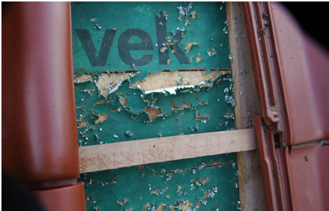
Schaden an Unterdach; Foto Dieter Stahl
