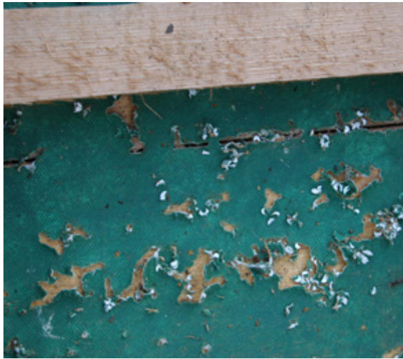
Fraßstellen über Stoß und auf Fläche
