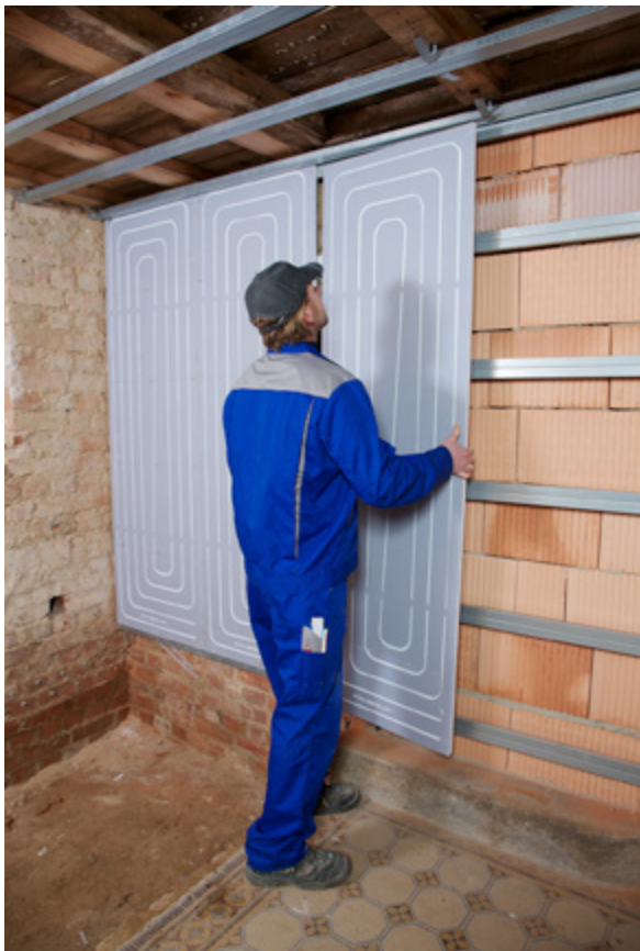
Wandheizung; alle Fotos uponor
