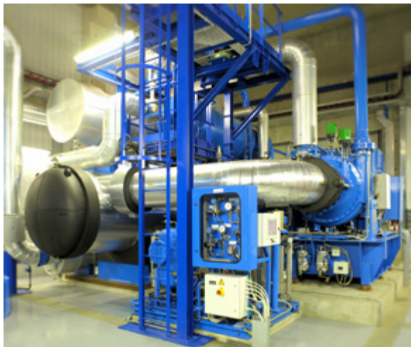
Wärmepumpen; Foto VDI
