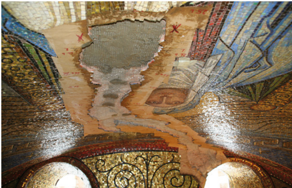
Riss in Deckenmosaik; Foto RTWH Aachen
