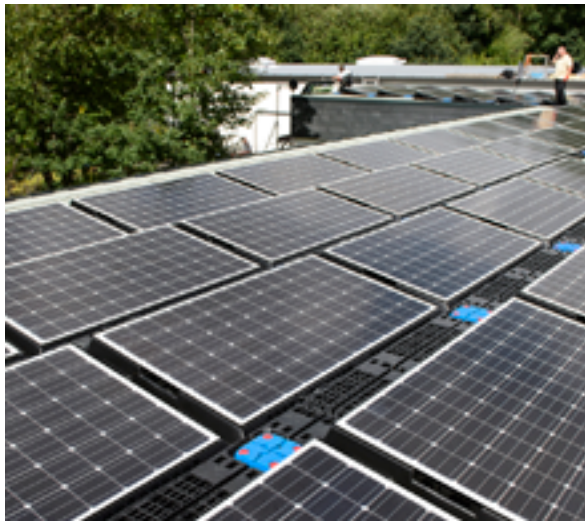
Solaranlage auf Flachdach
