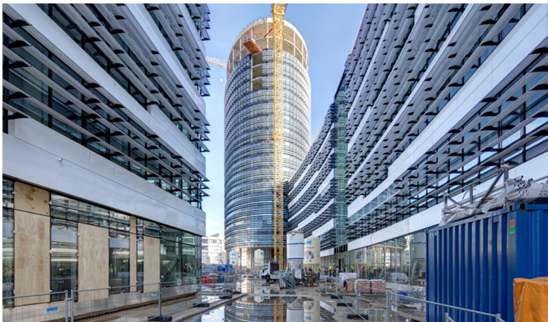
Vodafonzentrale Düsseldorf; Foto Zechbau
