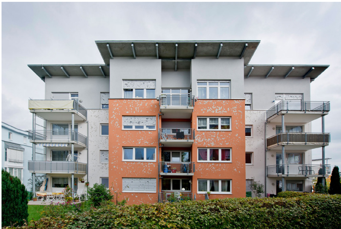
Fassadenbeschädigung; alle Fotos sto
