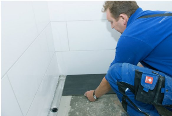
Linienentwässerung; Foto Starosta
