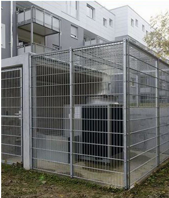
Die Buderus Gas-Absorptionswärmepumpe Logatherm GWPL 41 ist im Außenbereich des modernisierten Mehrfamilienhauses in Wernau aufgestellt.
