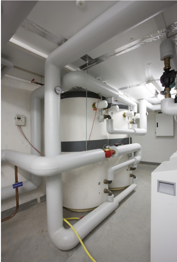
Der Technikraum mit moderner Heizungsanlage - rechts im Anschnitt die Wärmepumpen, gegenüber die neuen Speicher.
