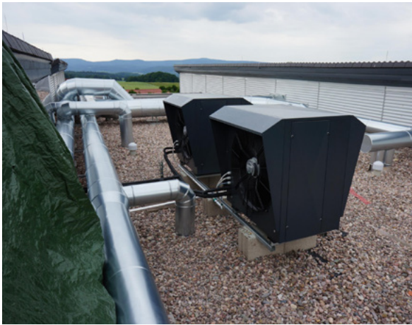
Die beiden Verdampfeinheiten der Bartl Luft Split Wärmepumpe auf dem Flachdach.
