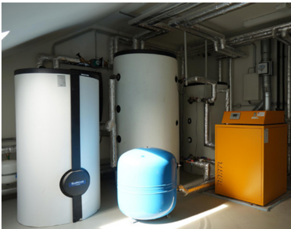
Der Technikraum im Dachgeschoss mit der Inneneinheit der Wärmepumpe, dem Gasbrennwertgerät und dem Warmwasserspeicher. Alle Fotos: Bartl Wärmepumpen
