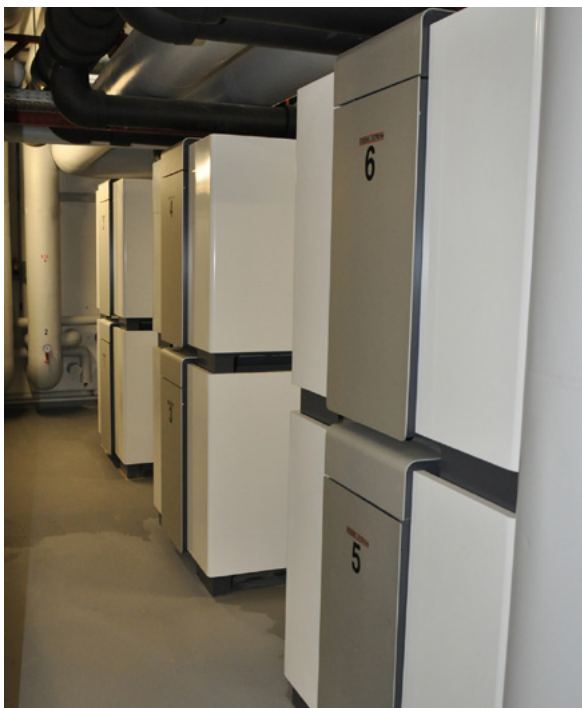
Sechs Großwärmepumpen WPF 66 von Stiebel Eltron versorgen den Komplex mit Wärme, bereiten das Warmwasser und übernehmen auch die Kühlung der Räume an heißen Tagen.
