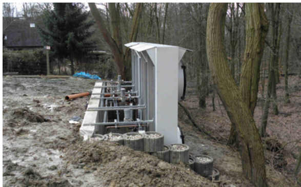
Verdampfer während der Bauphase. 4 Ventilatoren, mit fast 1 Meter Durchmesser, treiben die Außenluft über die Verdampferfläche.
