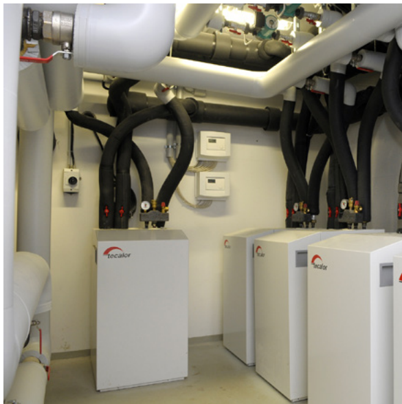
Fünf Wärmepumpen mit einer Leistung von je 16 Kilowatt wurden im Technikraum untergebracht. Sie sind neben der Heizung auch für die Warmwasserbereitung verantwortlich.
