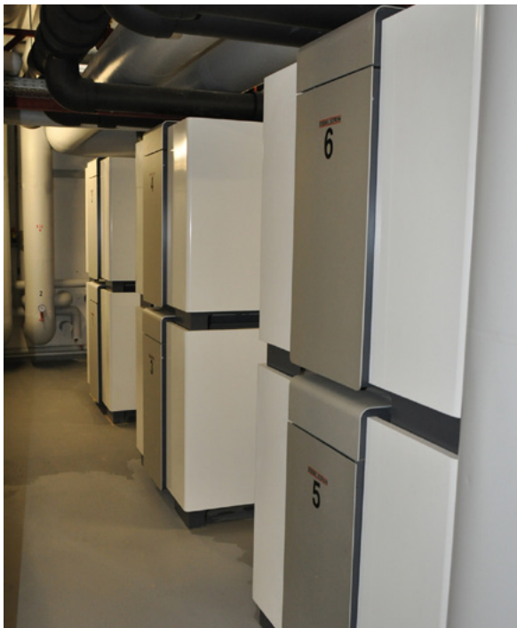
Sechs Großwärmepumpen WPF 66 von Stiebel Eltron versorgen den Komplex mit Wärme, bereiten das Warmwasser und übernehmen auch die Kühlung der Räume an heißen Tagen.
