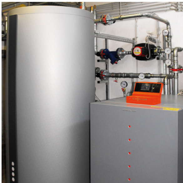
Viessmann Wärmepumpen-Anlage mit Solar-Eisspeicher
