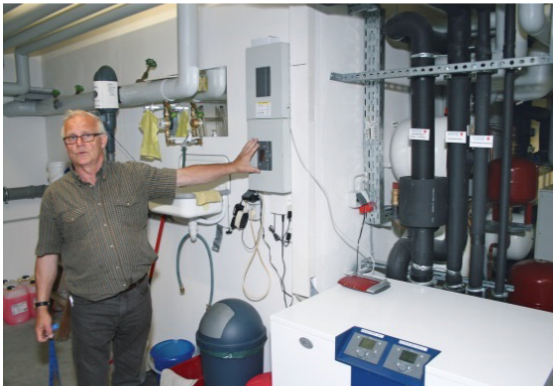
Martin Böcker, Installateur des Heizungssystems, erklärt die Funktionsweise der Kaskadenanlage von MHG.
