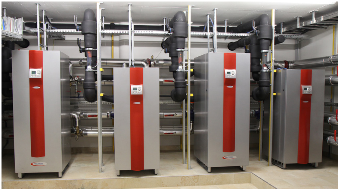
Hocheffizienz-Wärmepumpen von Heliotherm in Kaskade. Energiequelle Grundwasser; alle Fotos: Heliotherm
