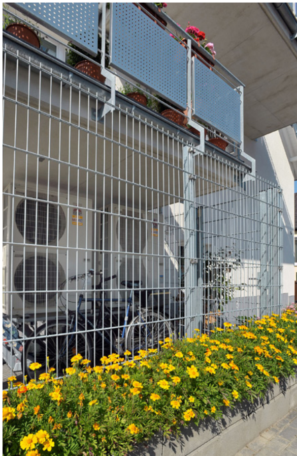
Zwei Luft/Wasser-Wärmepumpen versorgen das Objekt mit Raumwärme und Warmwasser; alle Fotos: Mitsubishi Electric
