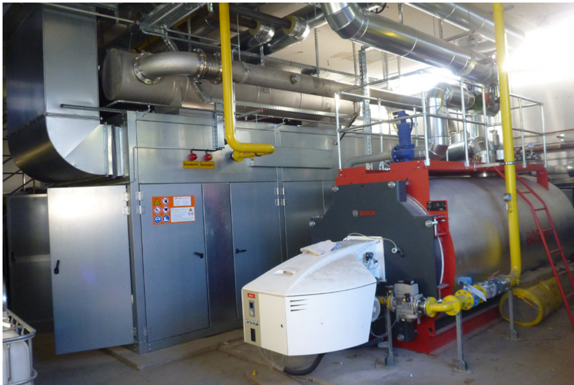
Urbana Eigenstrom BHKW Kessel; alle Fotos Urbana
