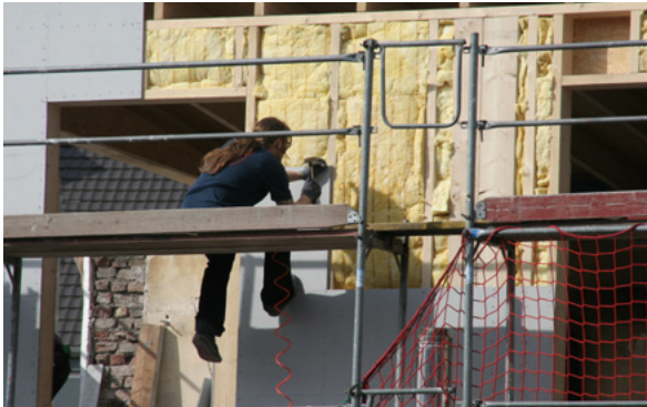
Dämmung Mineralwolle; Foto Krolkiewicz
