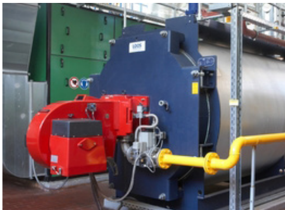
Heisanlage Foto Urbana
