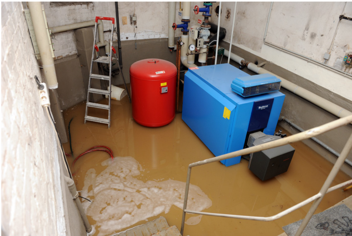
Wasserüberfluteter Heizungskeller, Foto Warda
