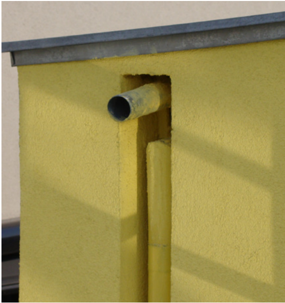
Die Abwasserleitung vom Flachdach ist zu kurz - das anfallende Wasser sucht sich an der Fassade den Weg nach unten
