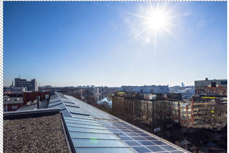
Photovoltaikanlage Reuchlinstraße; alle Fotos David von Becker
