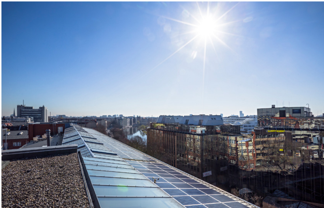
Photovoltaikanlage Reuchlinstraße; alle Fotos David von Becker
