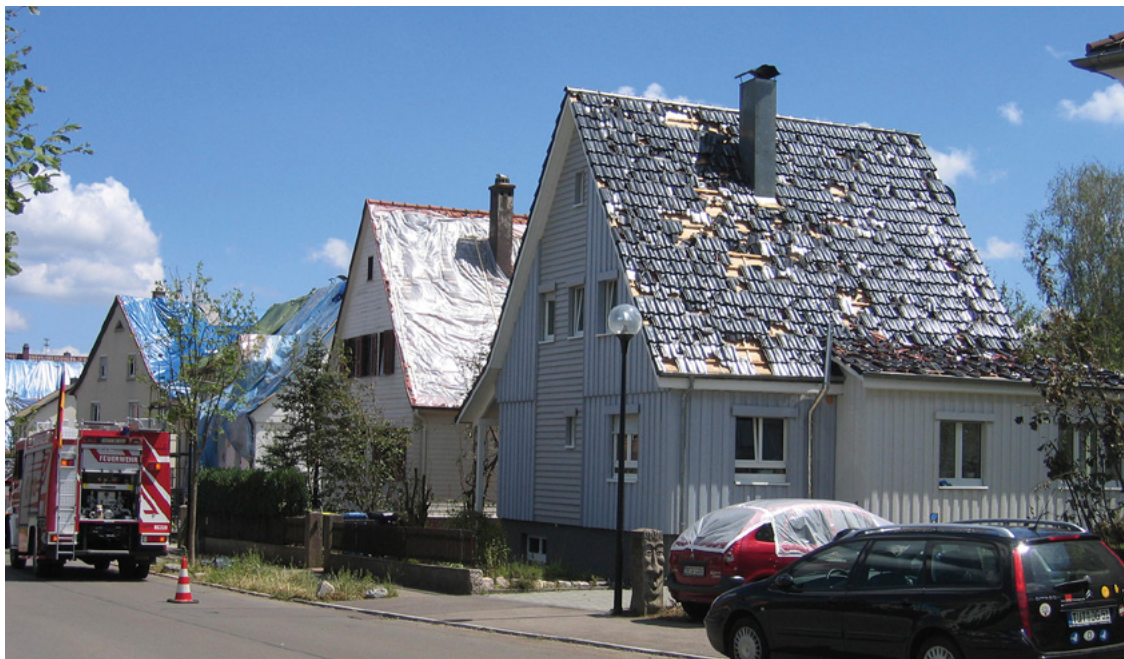
Hagelschaden Dächer; Foto Bauder
