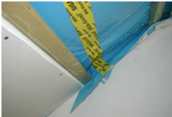
Unsachgemäßer Wandanschluss; Foto kro
