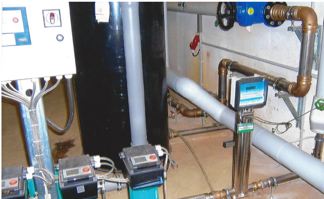
Technikraum; alle Fotos Paul Wittlich
