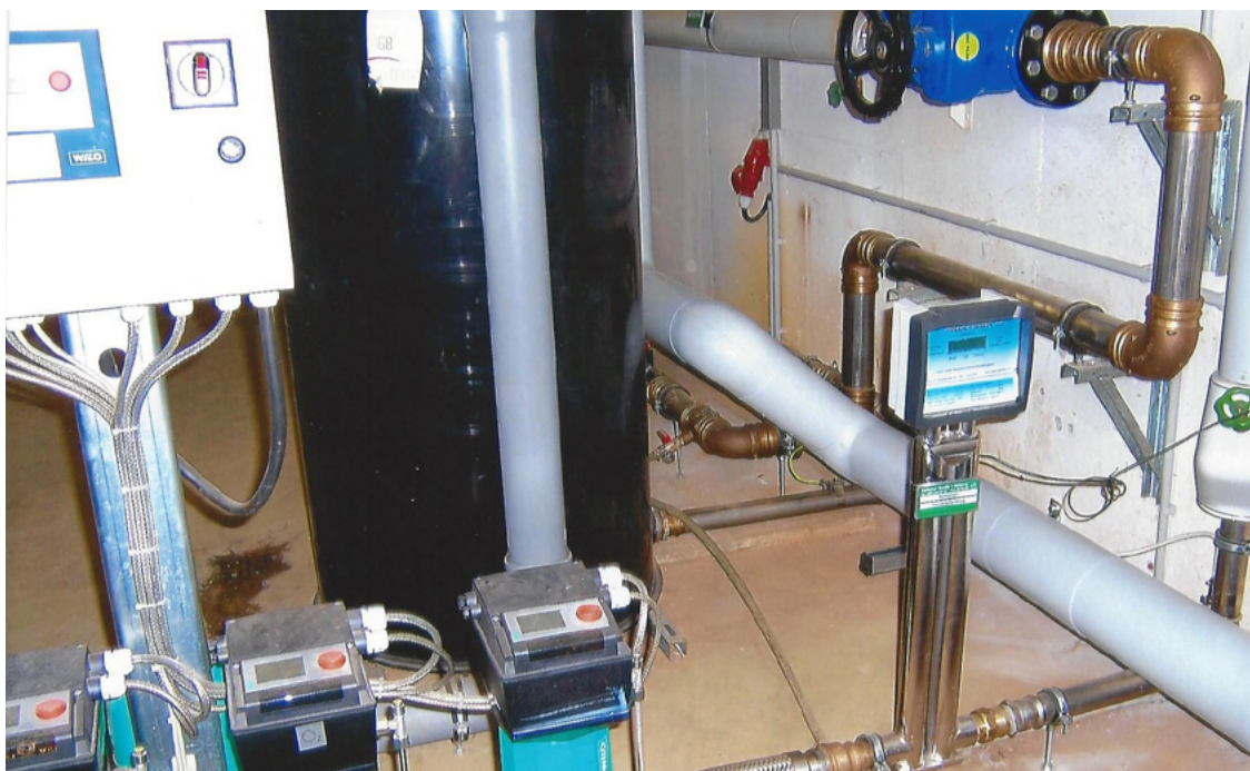
Technikraum; alle Fotos Paul Wittlich
