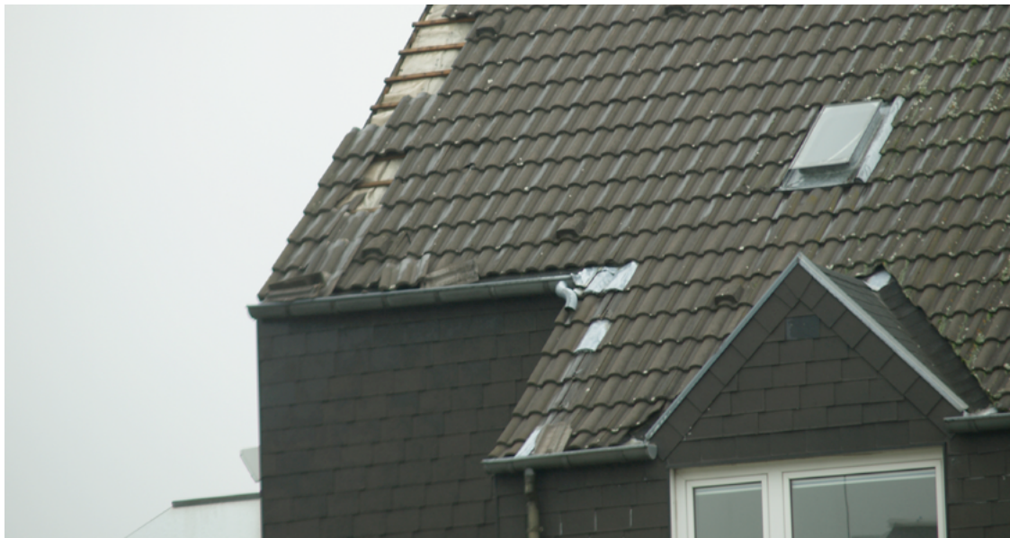
Sturmschaden am Ortgang; Foto FOS
