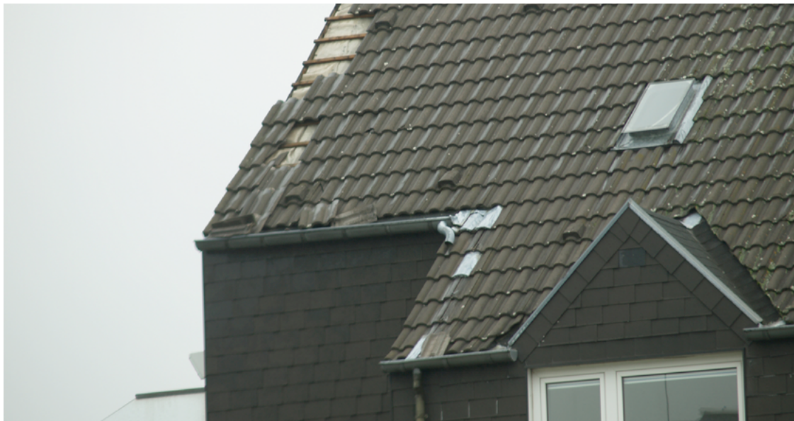
Sturmschaden am Ortgang; Foto FOS
