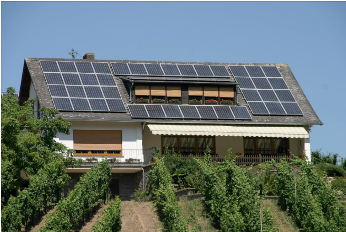
Solardach; Foto Krolkiewicz
