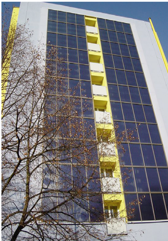
Fassadenkollektoren; Foto TiSUN
