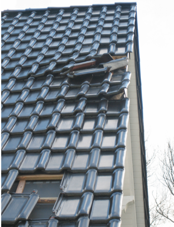
Sturmschaden Neudach; Foto FOS
