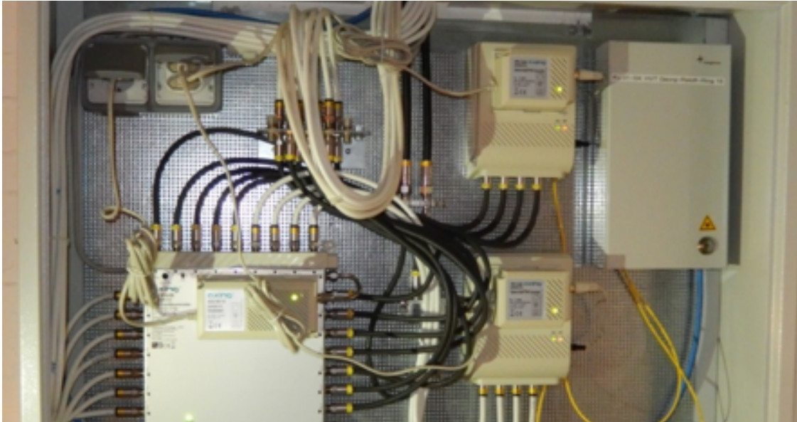
Zusammenführung von SAT und Kabelanschluss Foto Buchholz
