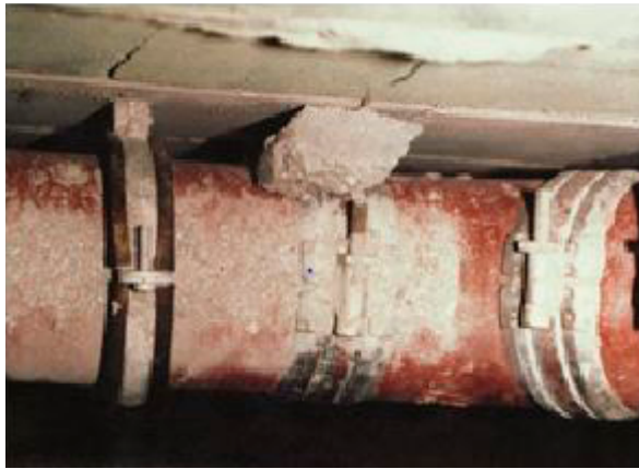
Schallübertragung an ungedämmten Rohren; Foto FSK
