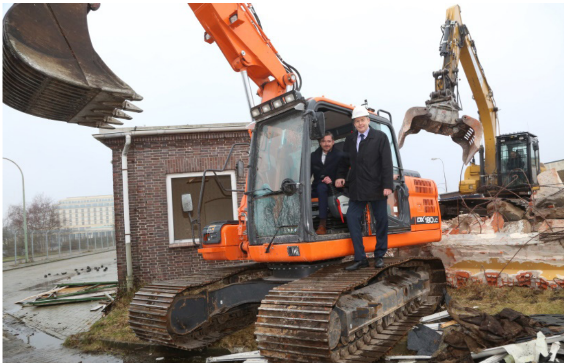
Startschuss für die Abbrucharbeiten. V.l.n.r.: Peter Krupinski (Vorstand SPAR + BAU), Dieter Wohler (Vorstandsvorsitzender SPAR + BAU). Foto: Spar+Bau
