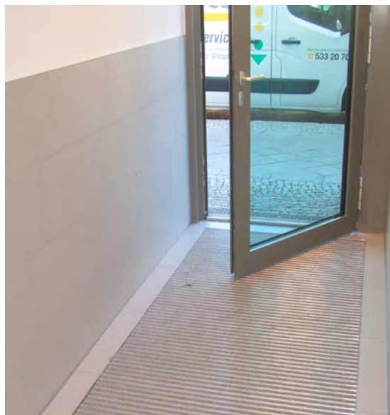
Rutschhemmender Bodenbelag im Eingangsbereich. Foto entnommen aus der Studie „Barrierefreies Wohnen im Kostenvergleich“
