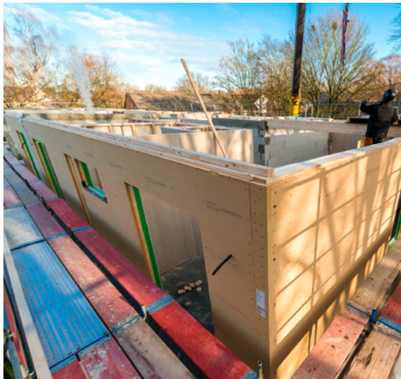
Aufstockung in der Blankensteiner Straße in Dortmund. Foto: Simon Bierwald / INDEED Photography
