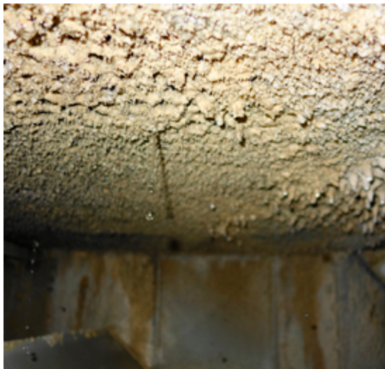
VDI begrüßt 42. BImSchV: Verbesserter Schutz vor Legionellen aus Rückkühlwerken (Bild: Rainer Krysch, Krysch Wasserhygiene)
