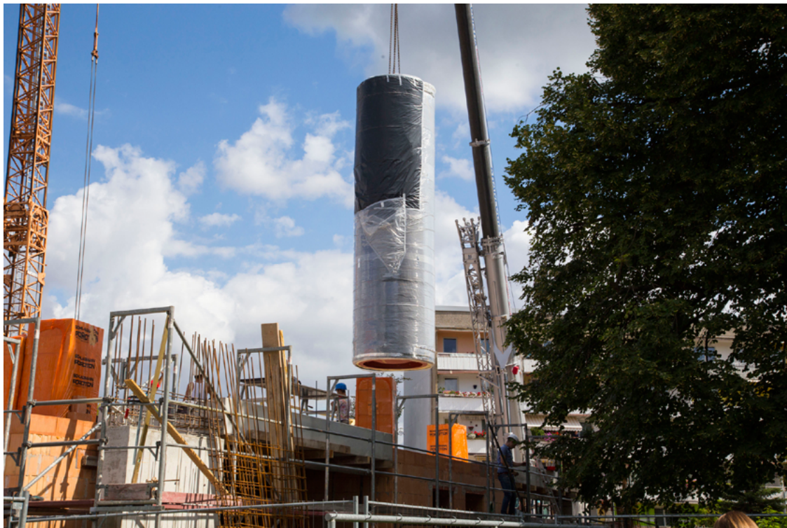
Herzstück zur Speicherung von Wärme ist der Solarspeicher, der ein Volumen von 24 Kubikmetern Wasser hat. Foto: HELMA Eigenheimbau AG
