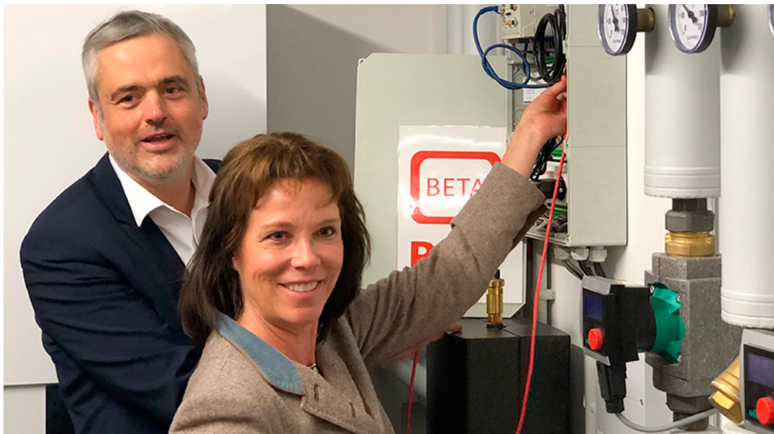
Stephanie Ladwig, Landrätin des Kreises Plön und VNW-Direktor Andreas Breitner in einem Heizungskeller. Foto: VNW
