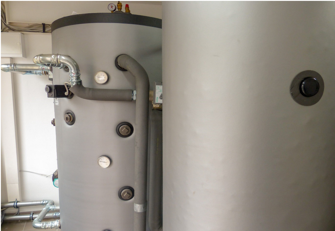
Heizzentrale Foto: BWP
