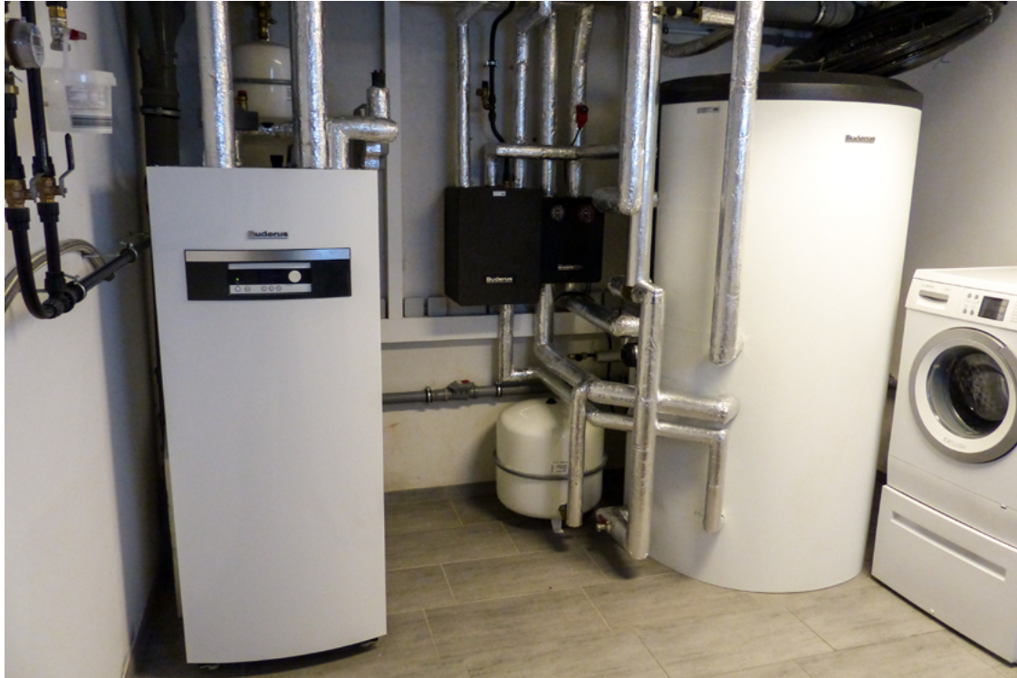
Ein Blick in den Heizraum. Foto: bwp
