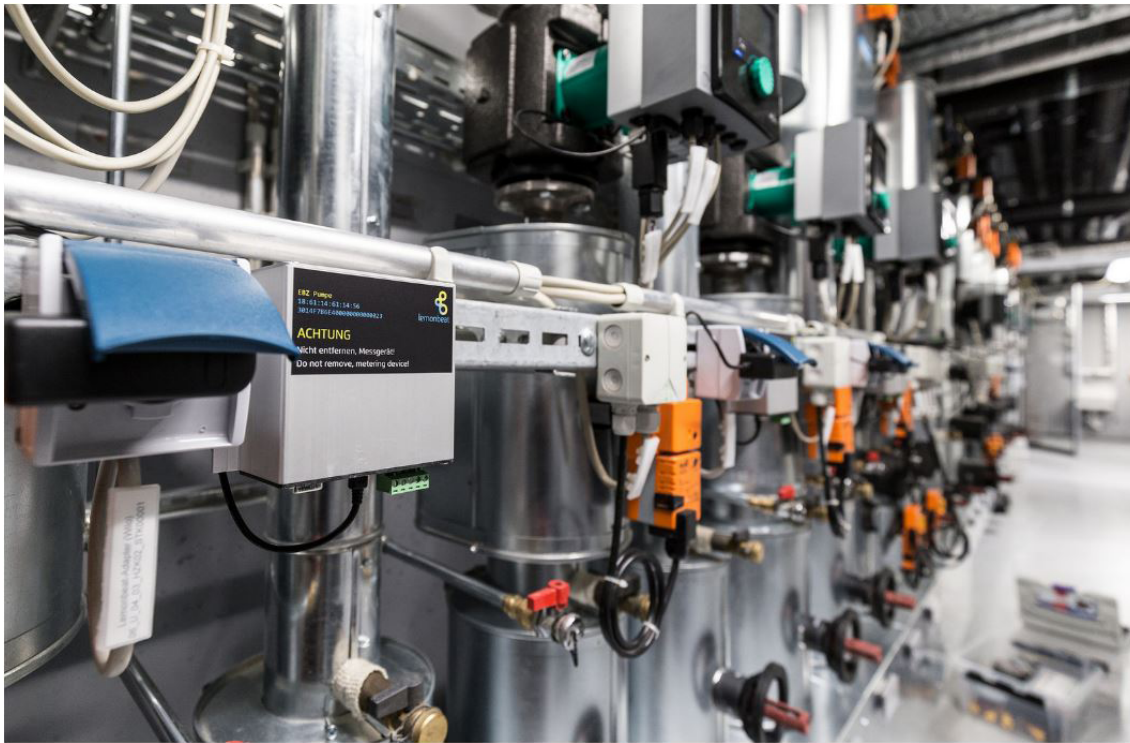
Der „smarte Heizungskeller“ im EBZ. Foto: Lemonbeat
