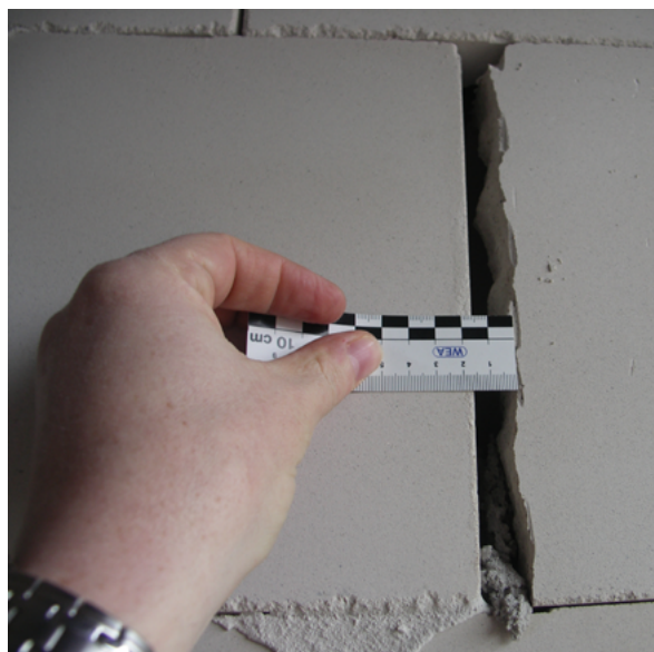
So sollte es nicht aussehen! Foto: Verband Privater Bauherren RB-Emsland
