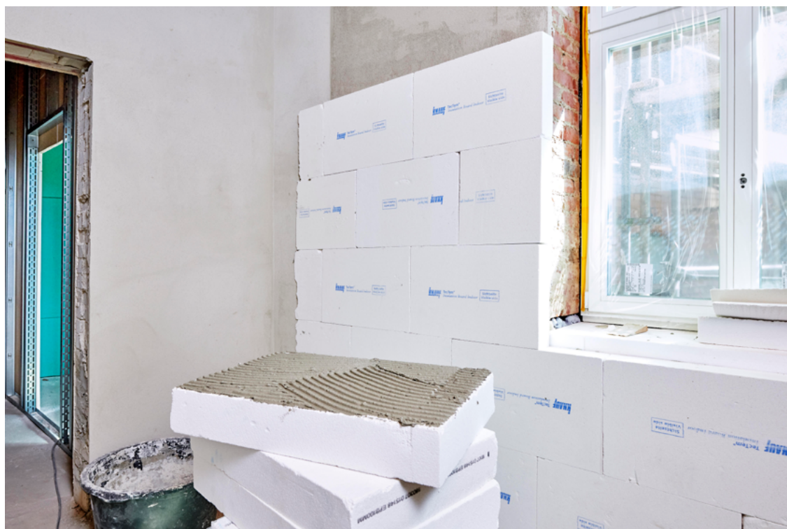
Einfaches Aufkleben: Die TecTem© Platten werden mit dem systemeigenen Klebspachtel vollflächig verklebt. Foto: KNAUF AQUAPANEL/E. Reinsch
