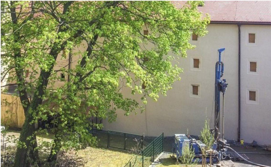
Kornhaus in Freiberg, Außenansicht Mit z.T. 205 Meter Bohrtiefe verfügt das Kornhaus über die tiefsten Sondenbohrungen des Freistaats Sachsen. (Bildquelle: Rudi Grimm / geoENERGIE Konzept).
