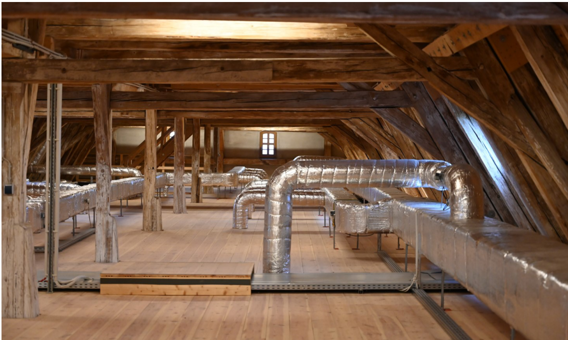
Dachgeschoss im alten Kornspeicher. Ein Blick auf die Verrohrung. Foto: BWP
