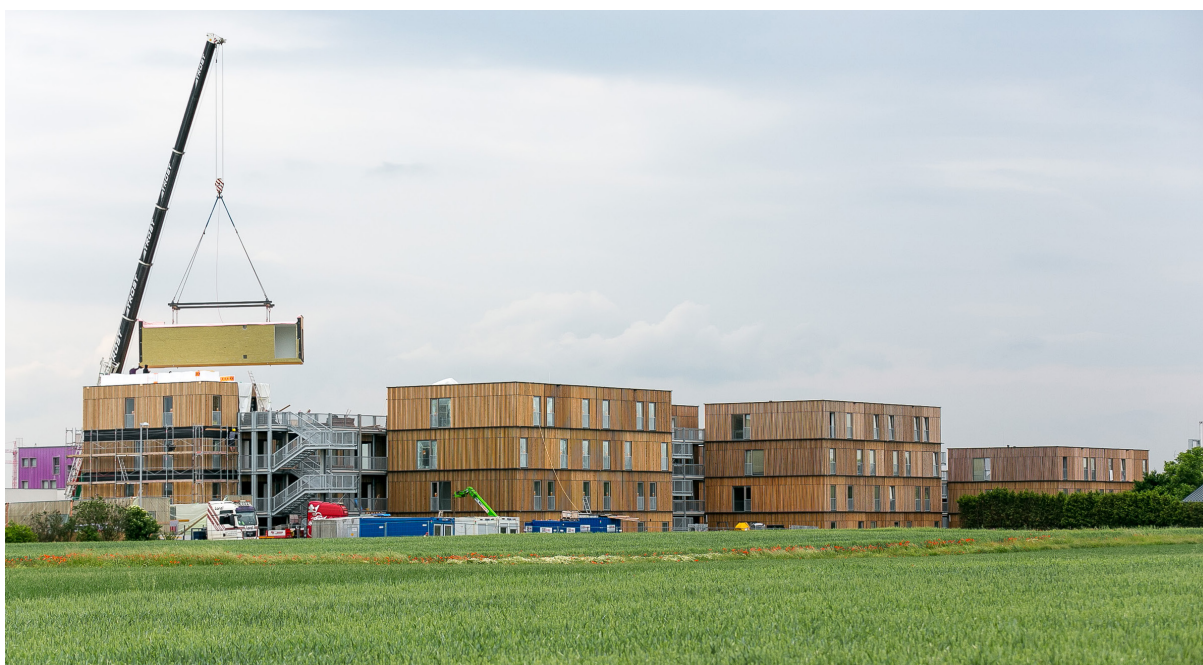
Modulbau mit Qualität: Die Wohnanlage Podhagskygasse der Siedlungsunion wurde aus vorgefertigten Raumzellen gestapelt.
