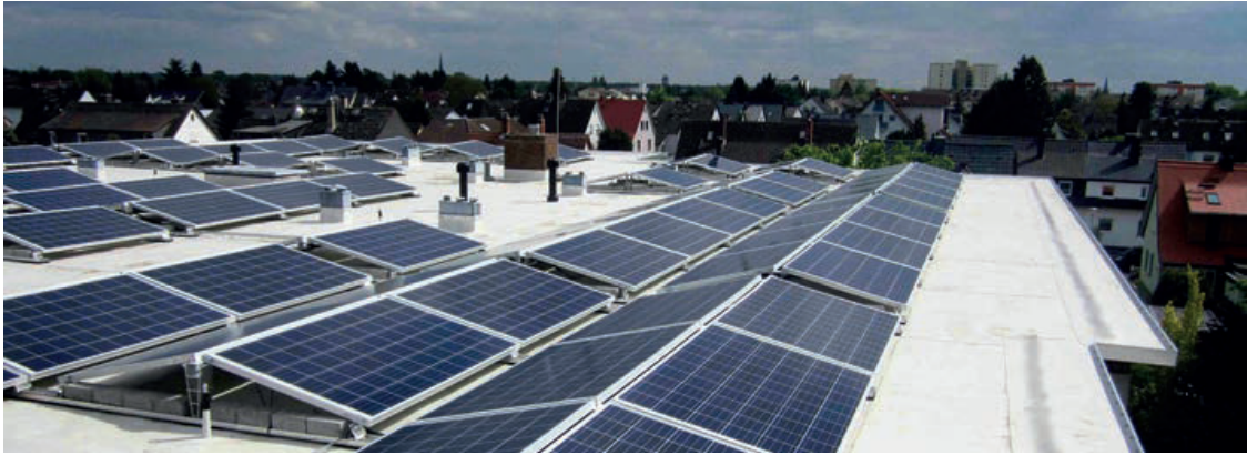
Auf dem Dach eines Gebäudes mit 21 Wohnungen der Baugenossenschaft Maintal eG arbeitet eine Mieterstromanlage. Durch die Nutzung des eigenen Stroms wird 20t CO 2 eingespart. Foto: Wircon
